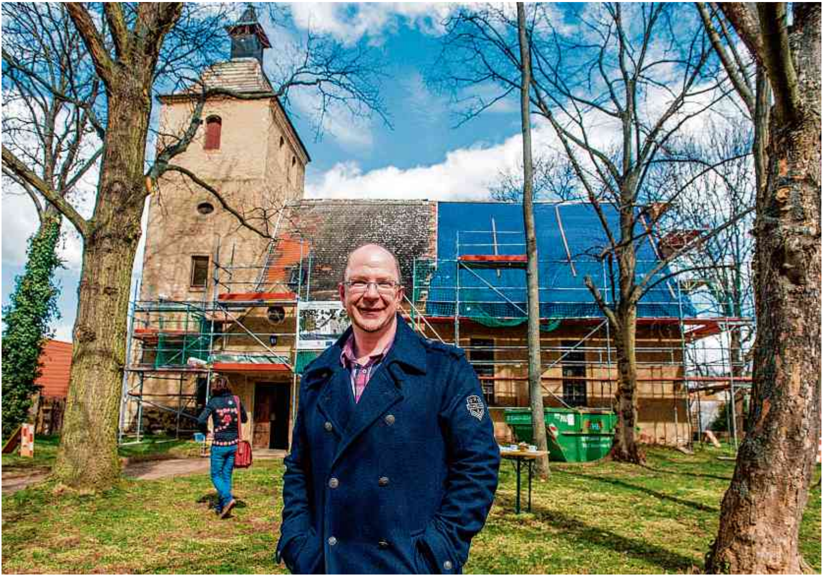
Ronny Krimm vom Heimatverein vor der Mösthinsdorfer Kirche. Mit der Dacherneuerung des Kirchenschiffs beginnt die Sanierung.
