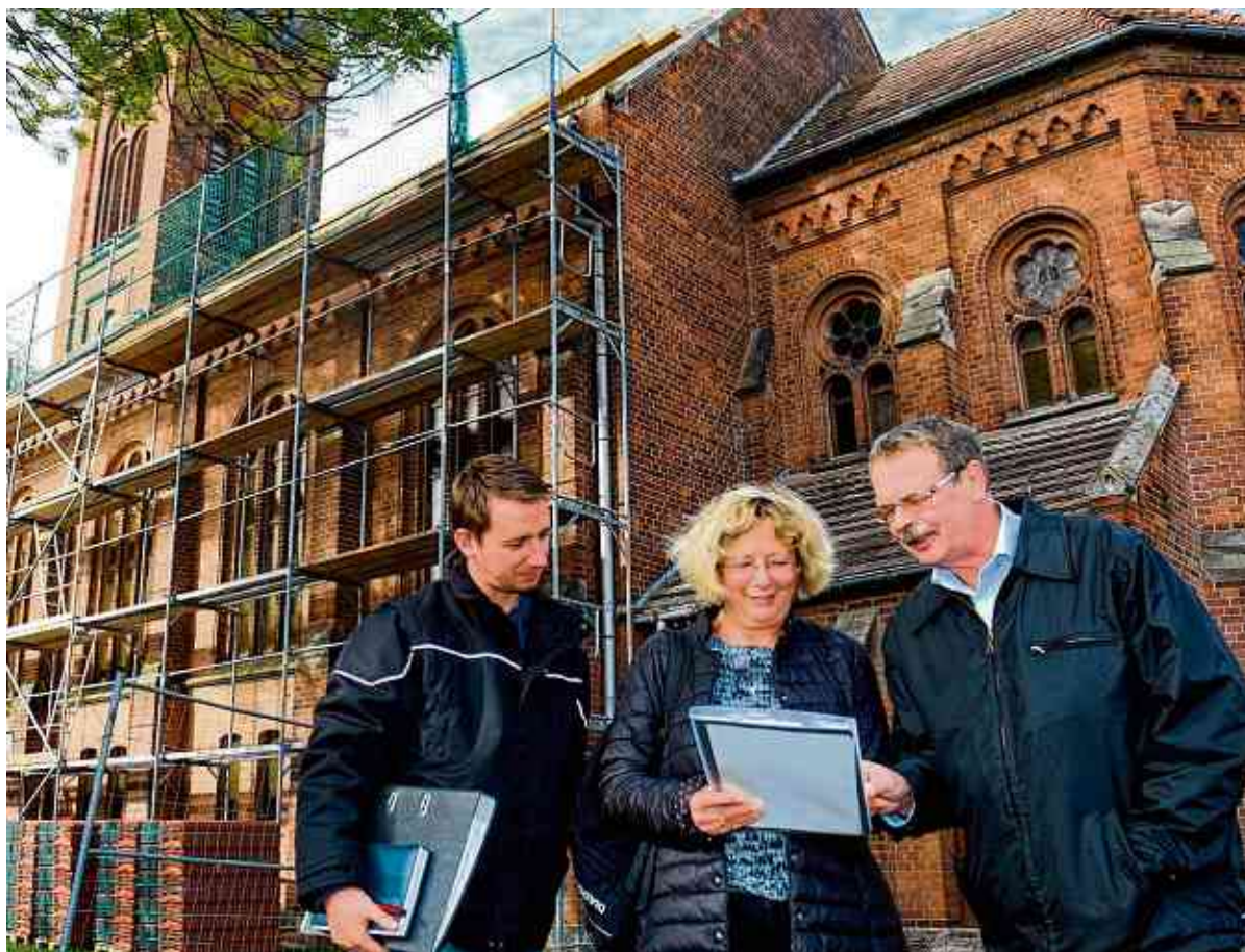
Dachdecker Martin Gerstenberger (von links), Architektin Angelika Bräunig und Pfarrer Karl-Heinz Schmidt besprechen regelmäßig die Bauarbeiten an der Gerbitzer Kirche.
